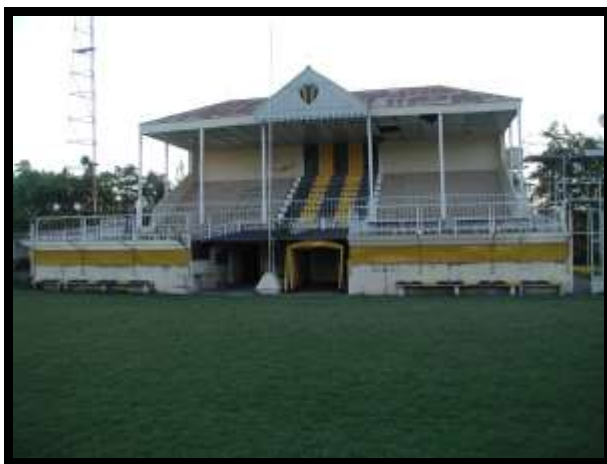
Vista actual de la platea de estilo inglés original del club Deportivo Libertad de Zúchales (Pcia. Santa Fe) inaugurada en 1928, declarada patrimonio histórico institucional y una de las pocas existentes en el país. Foto arq. Agustín García Puga ®
